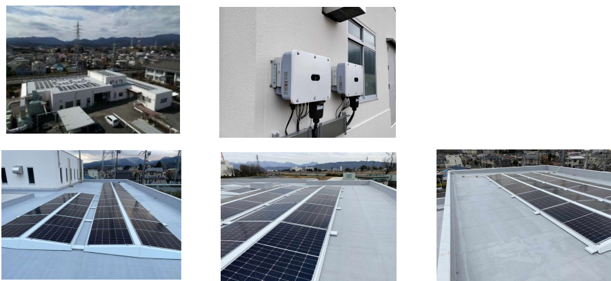
扇町クリーンセンター太陽光パネル
